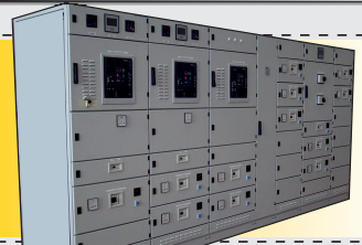
Power Center f.3b
