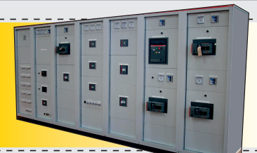
Quadro di distribuz.
